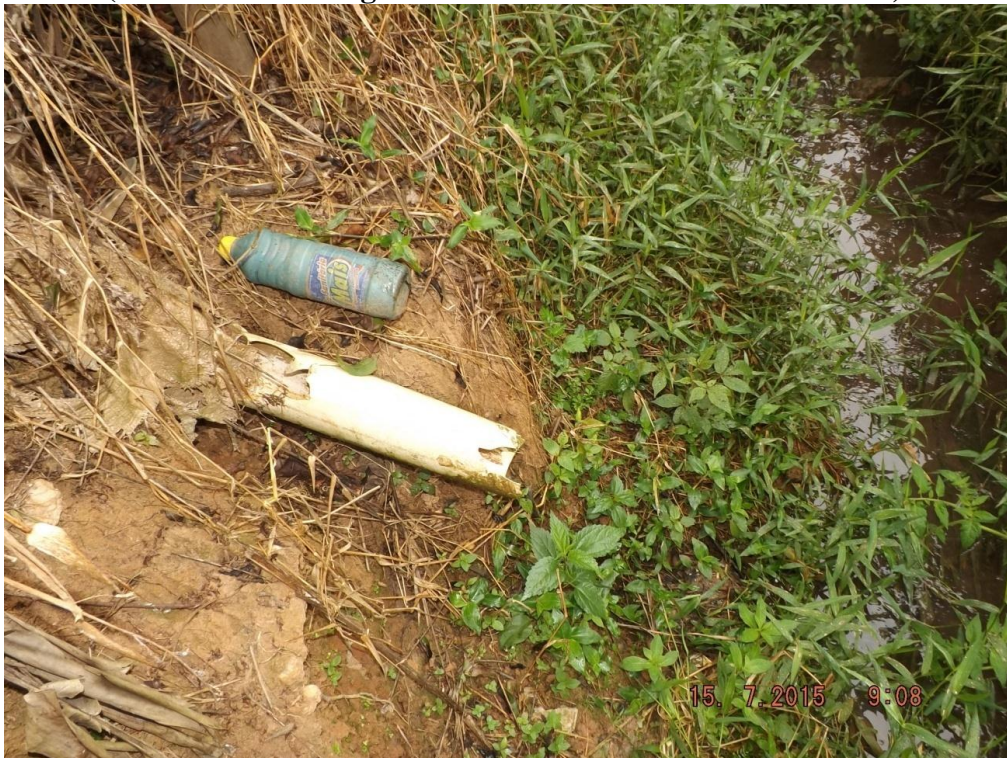
Figura 55: Lançamento de esgoto doméstico in natura no córrego São José da ilha (Coordenadas Geográficas: S 18°56'52.0" W 043°20'05.8")
