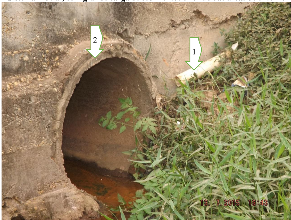
Figura 69: Cenário ilustrando a chegada das redes de esgoto (1) drenagem (2) no Sistema Fluvial, com grande carga de sedimentos oriundo das áreas de entorno
