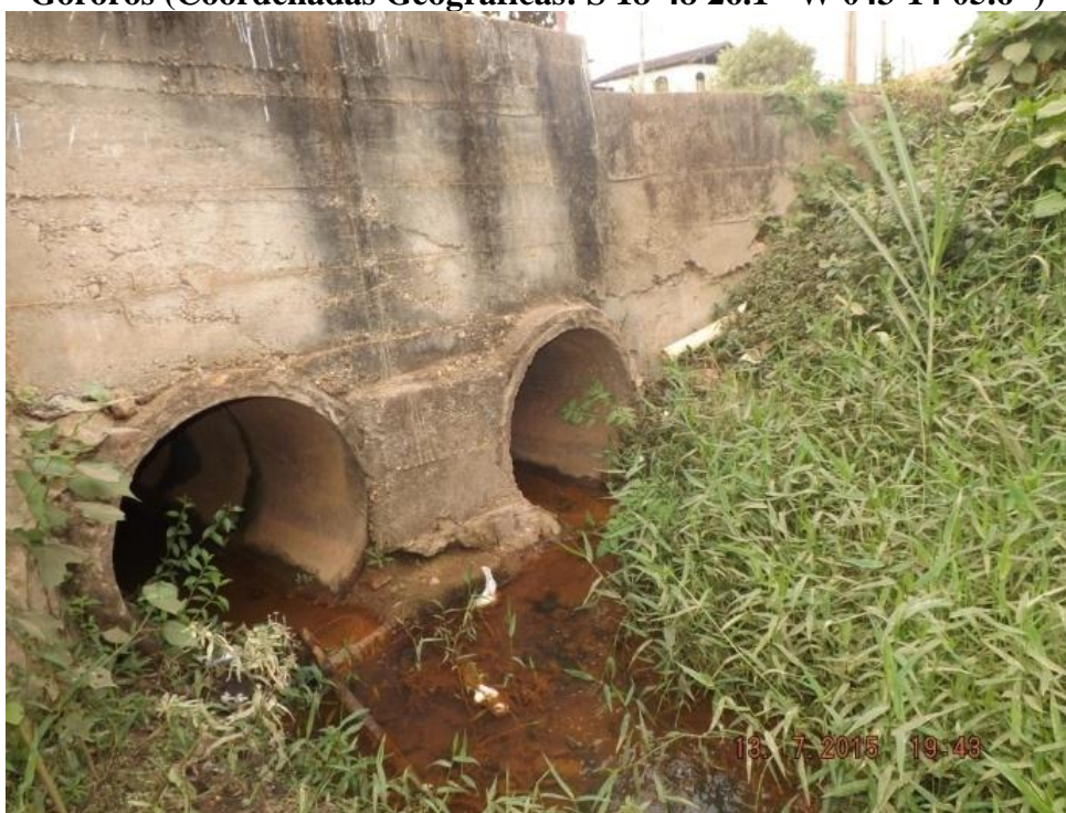
Figura 51: Lançamento de esgoto doméstico in natura no córrego Santana do distrito Gororós (Coordenadas Geográficas: S 18°48'26.1" W 043°14'05.6")
