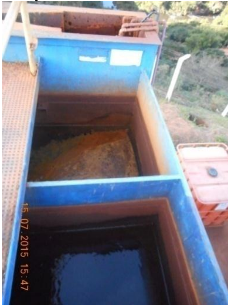
Figura 35: Vista superior do floculador (Local: S 18°57'54.6" W 043°15'06.5")
