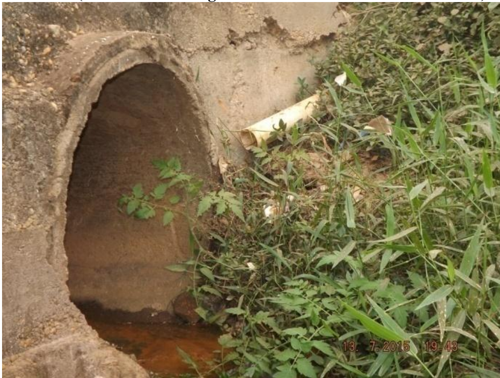
Figura 52: Lançamento de esgoto doméstico in natura no córrego Santana do distrito Gororós (Coordenadas Geográficas: S 18°48'26.1" W 043°14'05.6")
