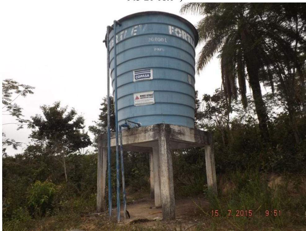
Figura 46: Reservatório de 20.000 L (Coordenada Geográfica: S 18°57'01.5" W 043°20'08.0")
