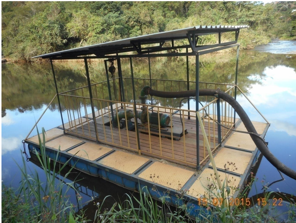
Figura 31: Balsa de Captação da água bruta no Rio Peixe. (Local: S 18°57'50.4" W 043°15'00.9")
