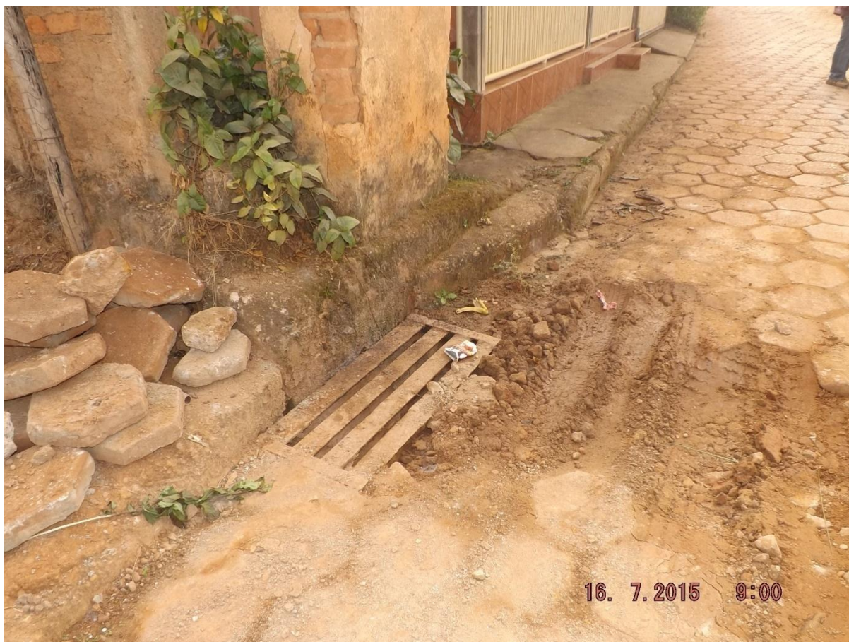
Figura 65: Resultado do carreamento de sedimentos/resíduos para a rede drenagem
